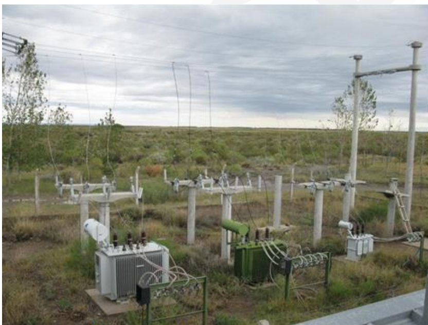
Figura 27. Línea de media tensión (33 kW) y estación de rebaje del Establecimiento San Bernardo.
